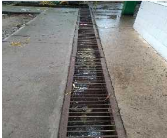
Foto No 2 canales de conducción de las aguas de vertimiento de las piscinas de lavado.
