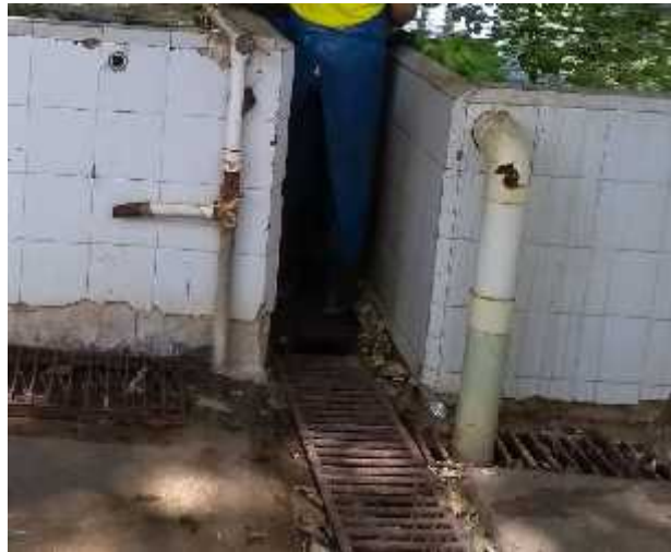
Foto No 3 Tubería de salida del agua residual después del proceso del lavado del banano
