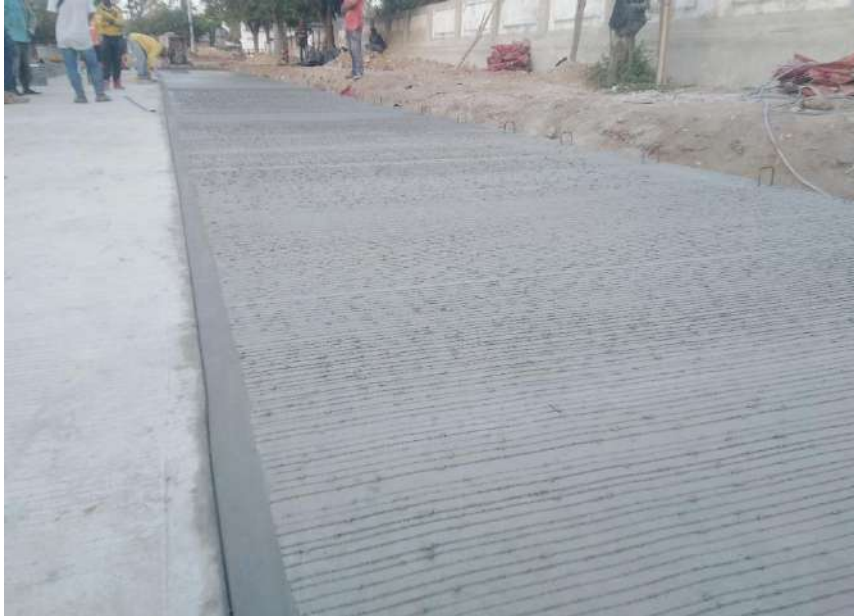
Imagen 7: Rayado de las placas de concreto
